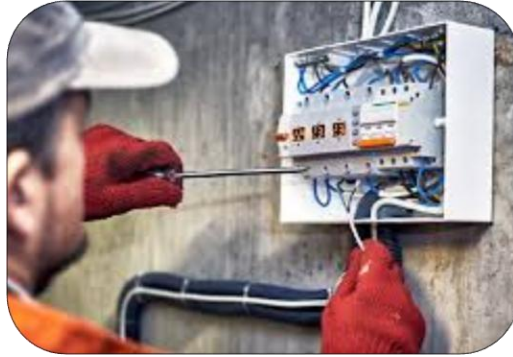
Modernización de REDES ELÉCTRICAS
